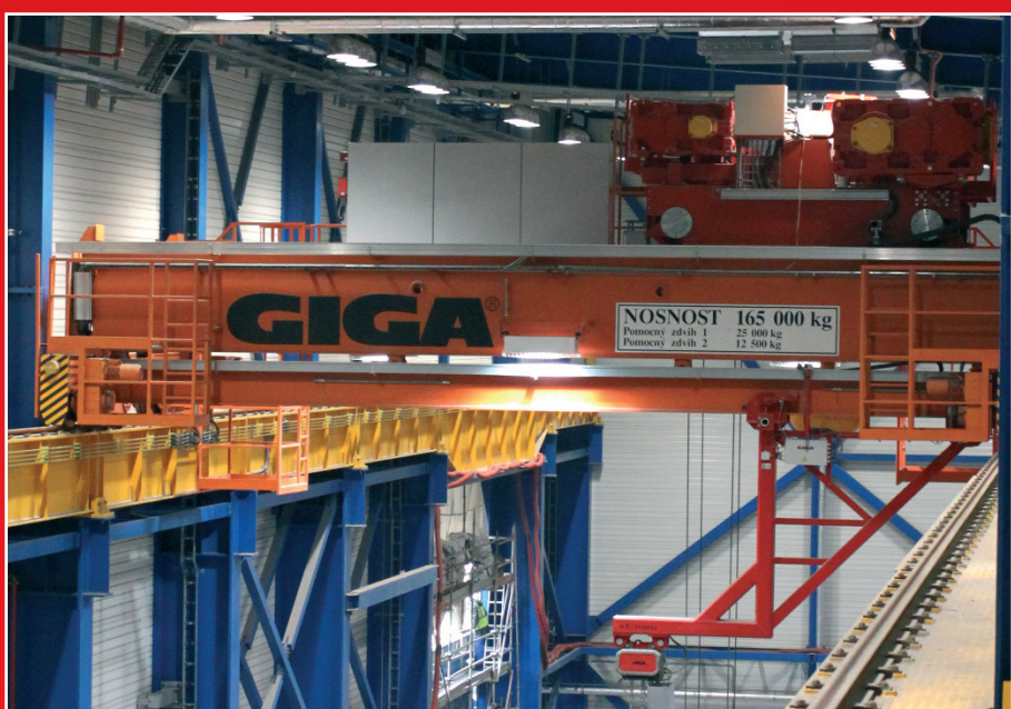
GDMJ 165t/25t/12,5t/11,5m – dvounoskový mostový jeřáb s kladkostrojí GIGA v elektrárně Počerady
