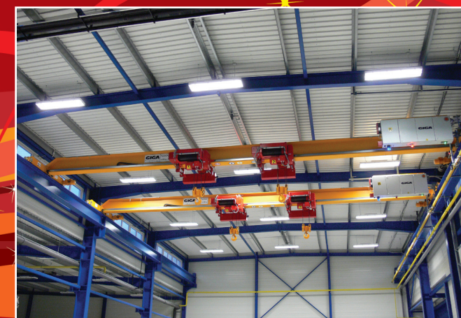
Dva jednonoskové mostové jeřáby GJMJ 2x6,3t/14m
