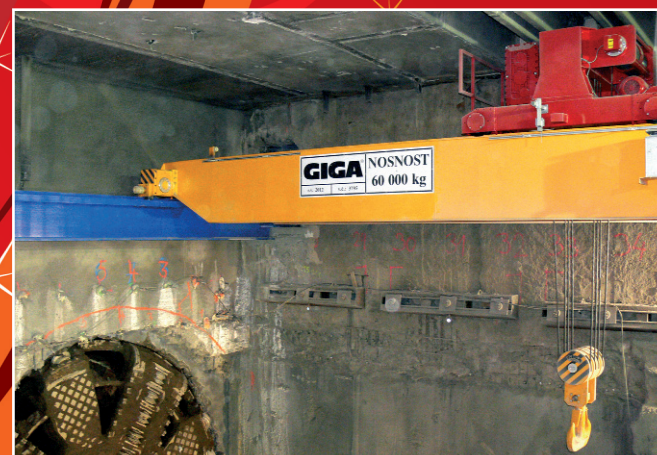
Dvounoskový mostový jeřáb GDMJ 60t/8,85m s jeřábovou dráhou pro firmu Metrostav k demontáži razicích štítů stanice metra Dejvická
