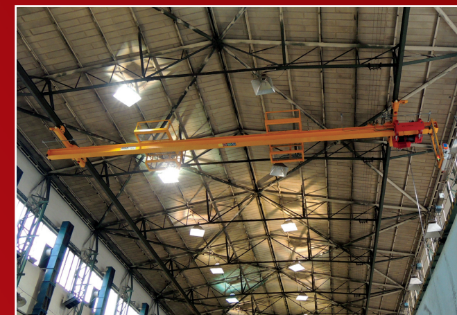
Podvěsný mostový jeřáb GPMJ 3,2t/15,02m s bočním vedením, rádiovým dálkovým ovládním a obslužnými plošinami
