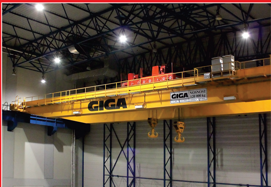
Dvounoskový mostový jeřáb GDMJ 120t/50t/41,25m s rozpětím 41,25 metrů v elektrárně Ledvice
