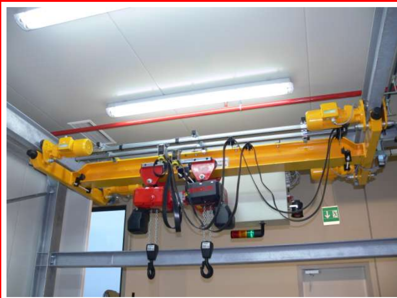
Подвесной мостовой кран тип GPMJ 2x0,5t/4,2m
